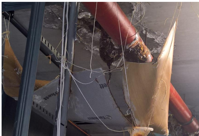
Figur 7-48 Kreativ løsning Aure for å fange vannlekkasje under basseng
